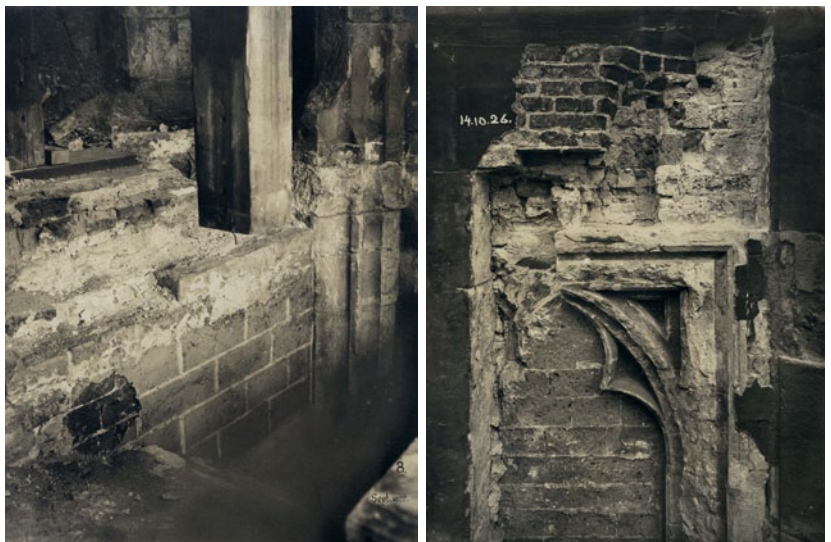
▲ Abb. 6 . Links: Tuffsteinwand mit Putz in Tuffsteinfarbe mit Scheinfugen, geborgen 1922 (Het Utrechts Archief, Katalog Nr. 222200). Rechts: Blindmaßwerks aus Weiberner Tuffstein bei der Restaurierung 1926 (Het Utrechts Archief, Katalog Nr. 222268). Bildquelle: Utrechter Archief, (Public domain 1.0)
